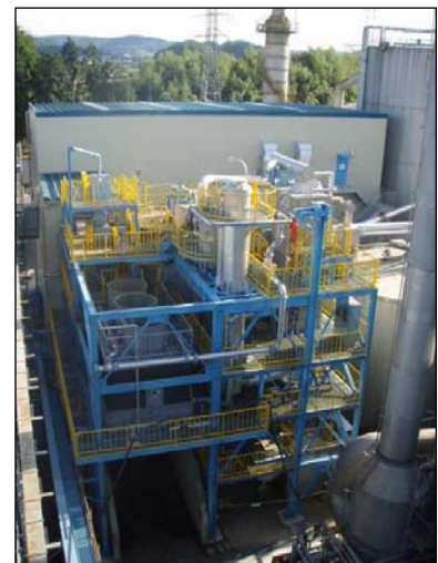
バイオマスガス化設備
