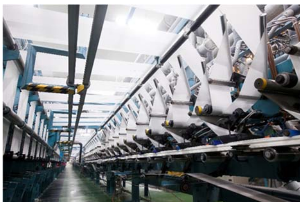
エリエールペーパー ティシュー加工設備
