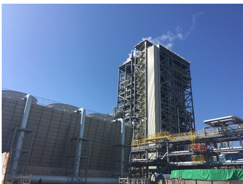
〈バイオマス発電設備〉
